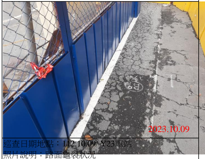
巡查日期地點：112.10.09/ Y23車站 照片說明：路面龜裂狀況
