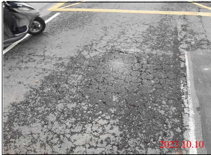
巡查日期地點：112.10.10/ Y23車站 照片說明：路面龜裂狀況
