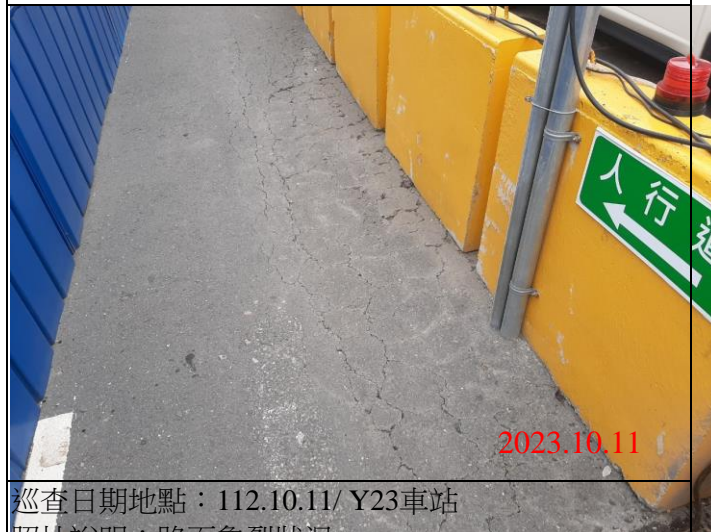
巡查日期地點：112.10.11/ Y23車站 照片說明：路面龜裂狀況
