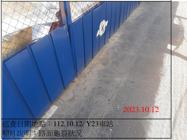
巡查日期地點：112.10.12/ Y23車站 照片說明：路面龜裂狀況
