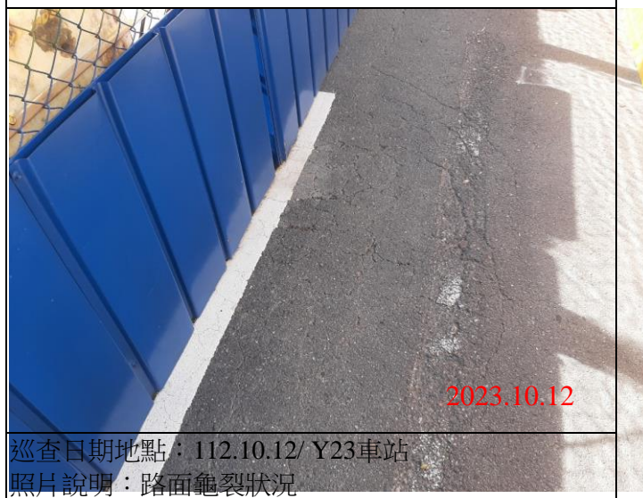
巡查日期地點：112.10.12/ Y23車站 照片說明：路面龜裂狀況
