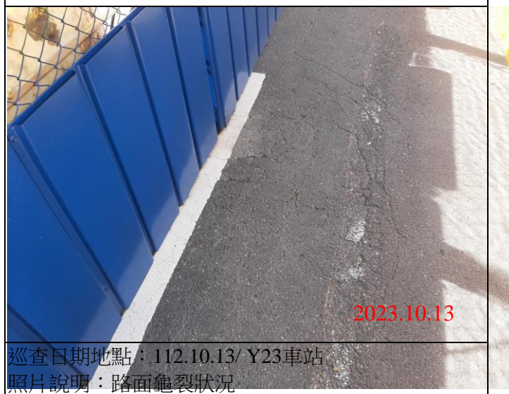
巡查日期地點：112.10.13/ Y23車站 照片說明：路面龜裂狀況
