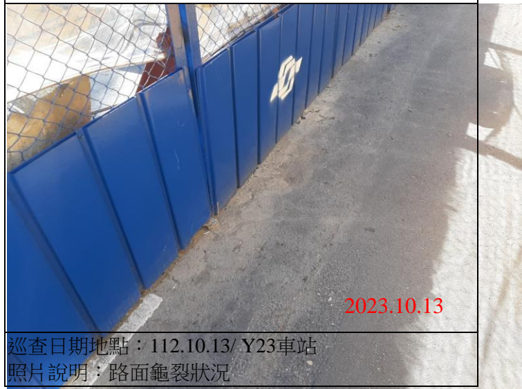
巡查日期地點：112.10.13/ Y23車站 照片說明：路面龜裂狀況
