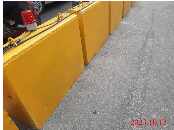
巡查日期地點：112.10.17/ Y23車站 照片說明：路面龜裂狀況
