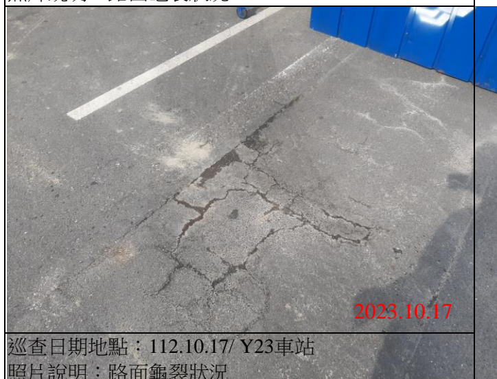
巡查日期地點：112.10.17/ Y23車站 照片說明：路面龜裂狀況
