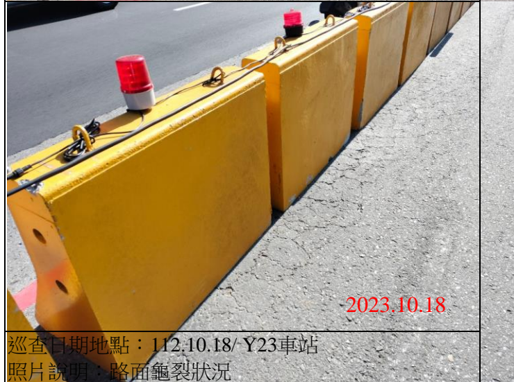
巡查日期地點：112.10.18/ Y23車站 照片說明：路面龜裂狀況
