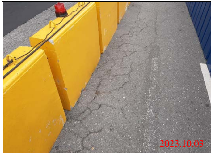
巡查日期地點：112.10.03/ Y23車站 照片說明：路面龜裂狀況
