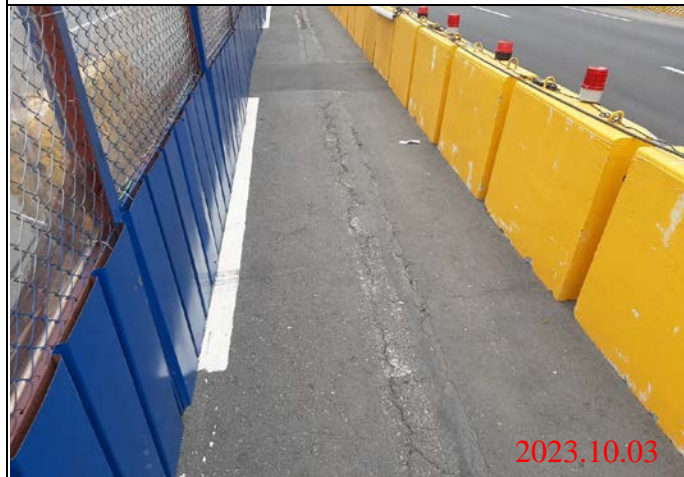
巡查日期地點：112.10.03/ Y23車站 照片說明：路面龜裂狀況
