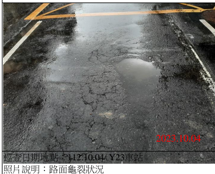
巡查日期地點：112.10.04/ Y23車站 照片說明：路面龜裂狀況
