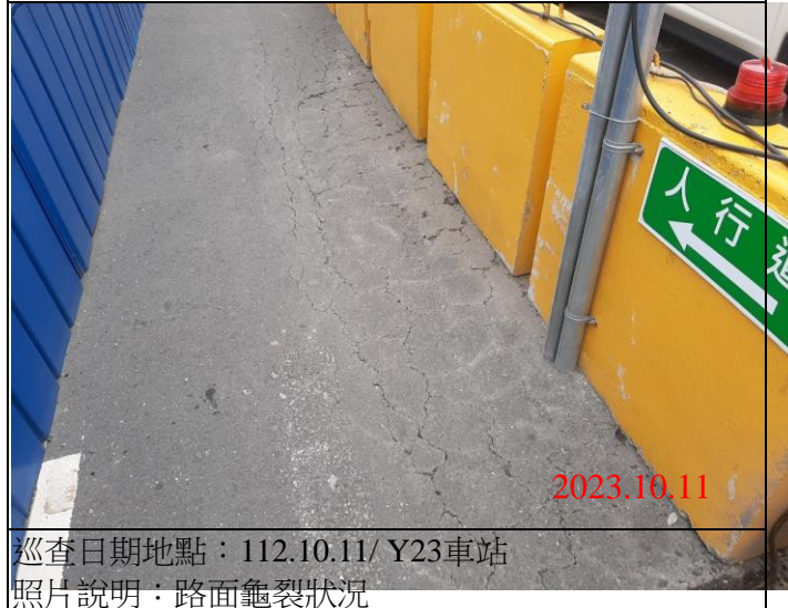
巡查日期地點：112.10.11/ Y23車站 照片說明：路面龜裂狀況
