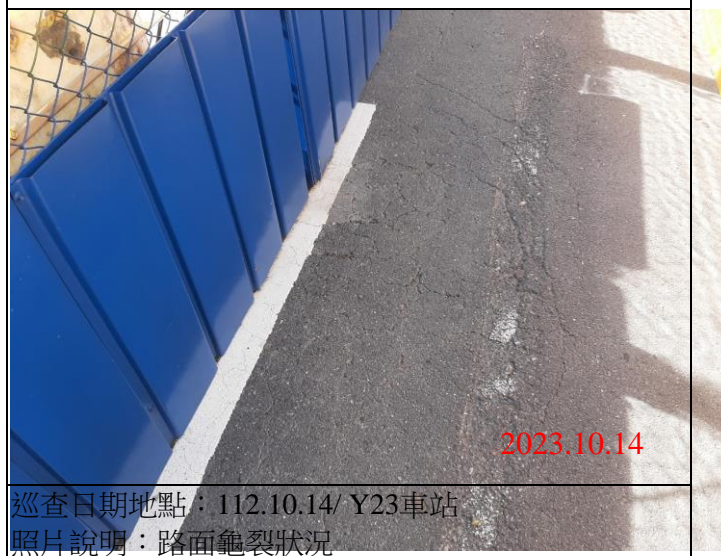
巡查日期地點：112.10.14/ Y23車站 照片說明：路面龜裂狀況
