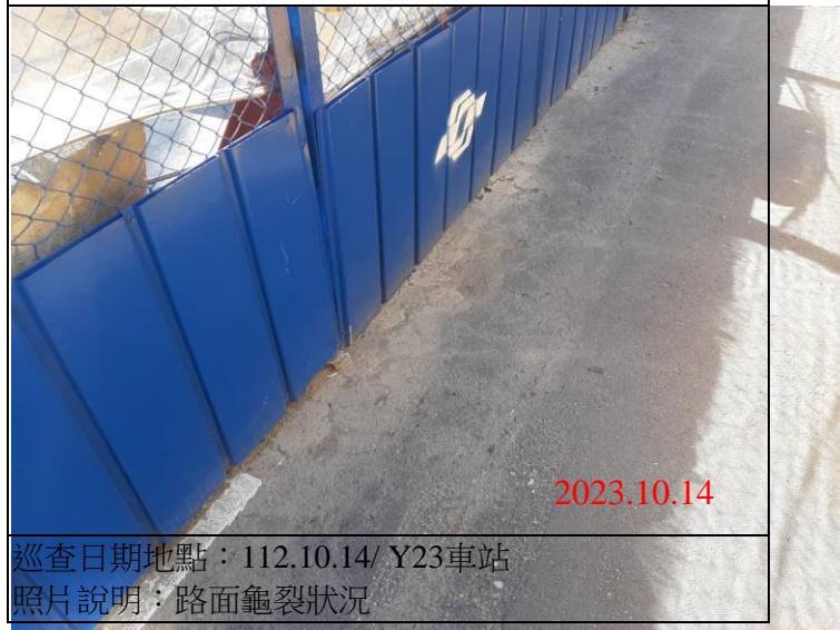
巡查日期地點：112.10.14/ Y23車站 照片說明：路面龜裂狀況
