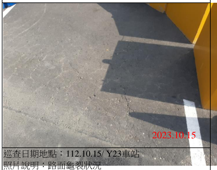
巡查日期地點：112.10.15/ Y23車站 照片說明：路面龜裂狀況
