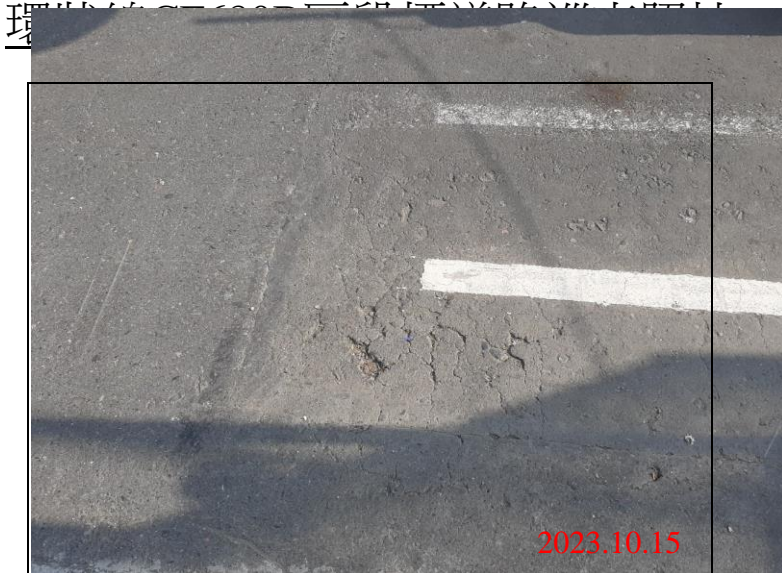
巡查日期地點：112.10.15/ Y23車站 照片說明：路面龜裂狀況
