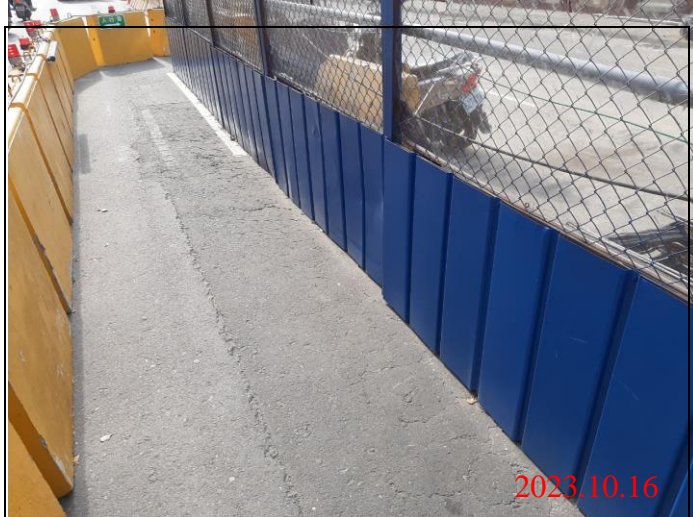
巡查日期地點：112.10.16/ Y23車站 照片說明：路面龜裂狀況
