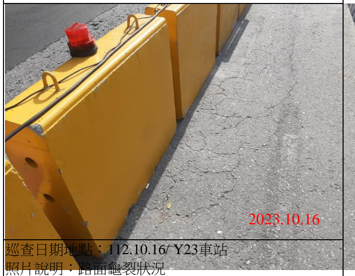
巡查日期地點：112.10.16/ Y23車站 照片說明：路面龜裂狀況
