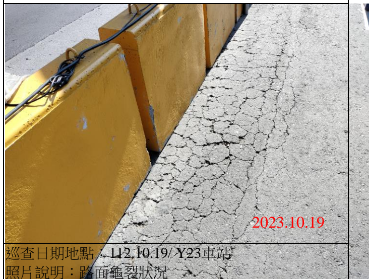
巡查日期地點：112.10.19/ Y23車站 照片說明：路面龜裂狀況
