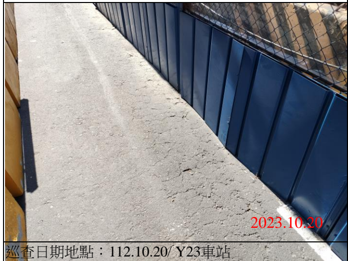
巡查日期地點：112.10.20/ Y23車站 照片說明：路面龜裂狀況
