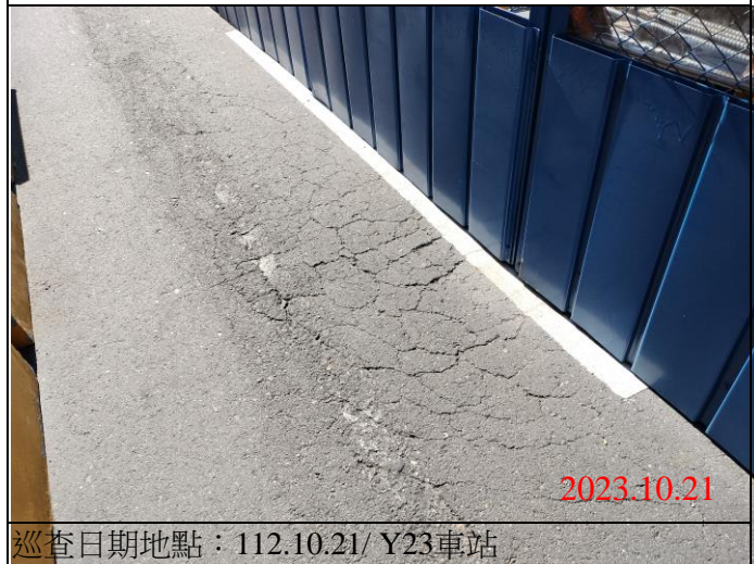
巡查日期地點：112.10.21/ Y23車站 照片說明：路面龜裂狀況
