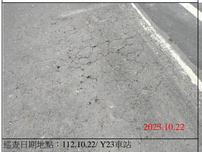
巡查日期地點：112.10.22/ Y23車站 照片說明：路面龜裂狀況
