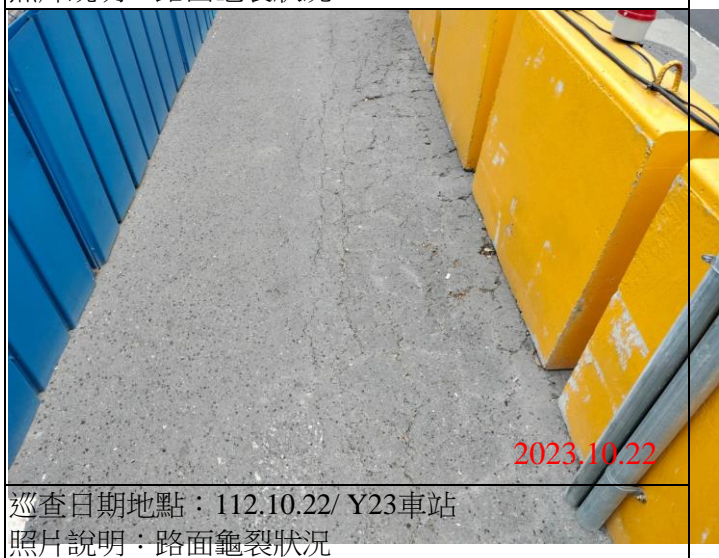
巡查日期地點：112.10.22/ Y23車站 照片說明：路面龜裂狀況
