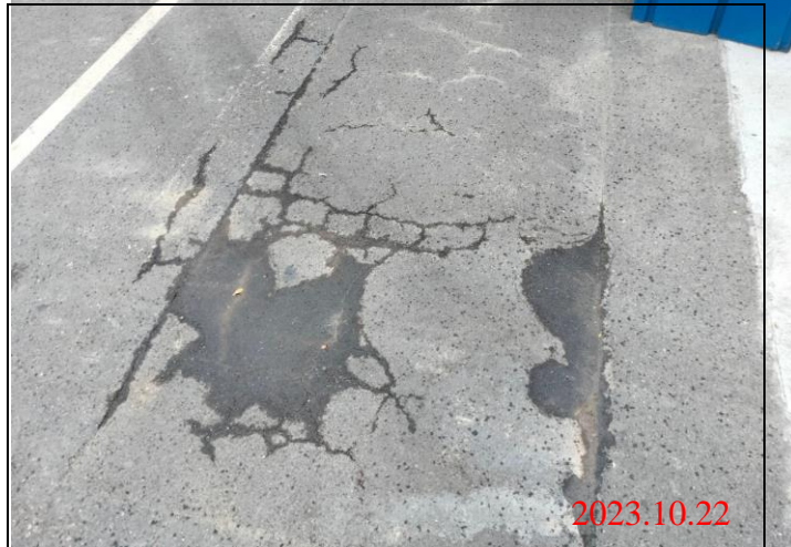
巡查日期地點：112.10.22/ Y23車站 照片說明：路面龜裂狀況
