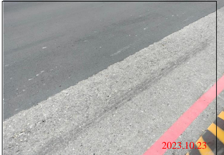
巡查日期地點：112.10.23/ Y23車站 照片說明：路面龜裂狀況
