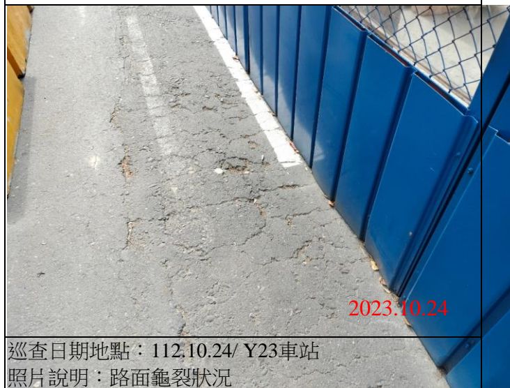
巡查日期地點：112.10.24/ Y23車站 照片說明：路面龜裂狀況
