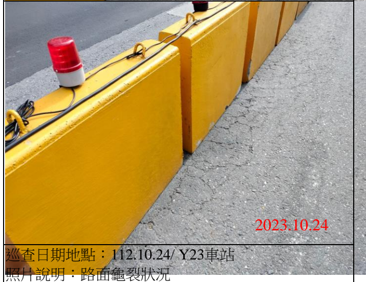
巡查日期地點：112.10.24/ Y23車站 照片說明：路面龜裂狀況
