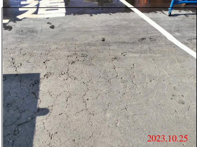
巡查日期地點：112.10.25/ Y23車站 照片說明：路面龜裂狀況
