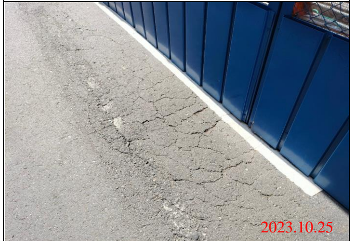
巡查日期地點：112.10.25/ Y23車站 照片說明：路面龜裂狀況
