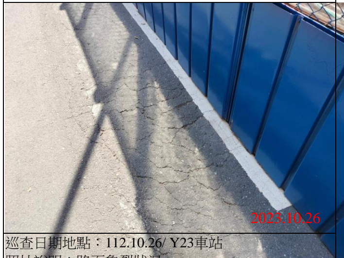
巡查日期地點：112.10.26/ Y23車站 照片說明：路面龜裂狀況
