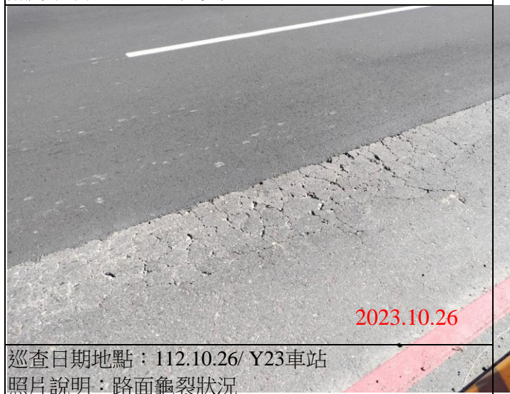
巡查日期地點：112.10.26/ Y23車站 照片說明：路面龜裂狀況
