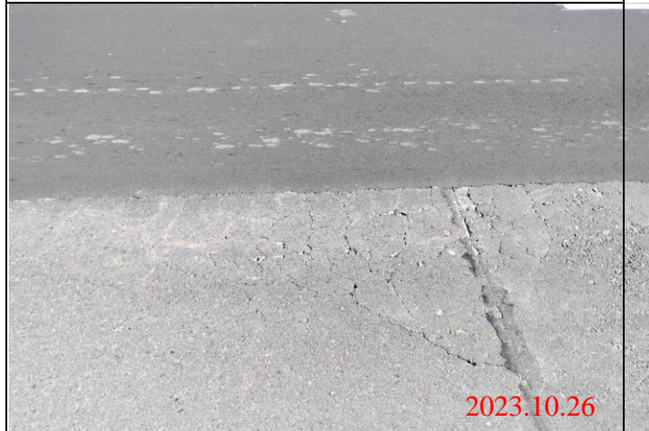
巡查日期地點：112.10.26/ Y23車站 照片說明：路面龜裂狀況
