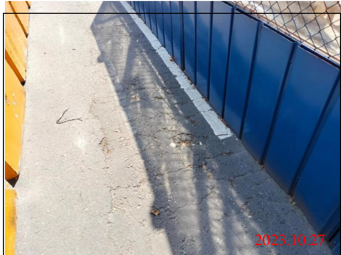
巡查日期地點：112.10.27/ Y23車站 照片說明：路面龜裂狀況
