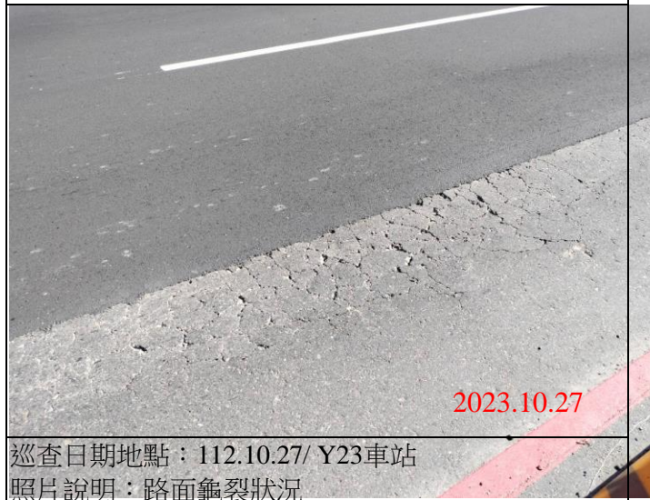
巡查日期地點：112.10.27/ Y23車站 照片說明：路面龜裂狀況
