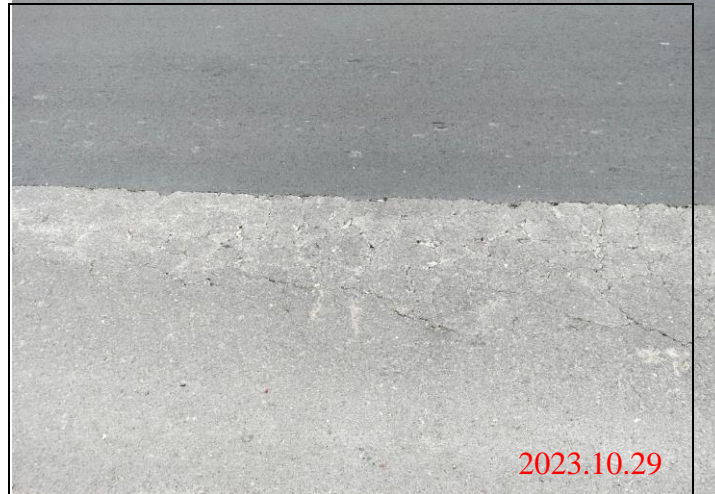
巡查日期地點：112.10.29/ Y23車站 照片說明：路面龜裂狀況
