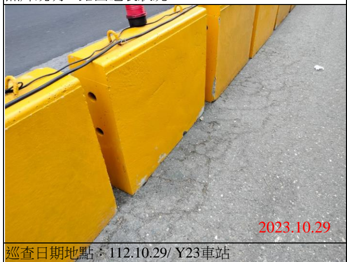
巡查日期地點：112.10.29/ Y23車站 照片說明：路面龜裂狀況
