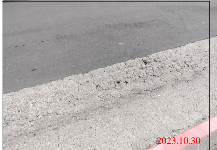
巡查日期地點：112.10.30/ Y23車站 照片說明：路面龜裂狀況
