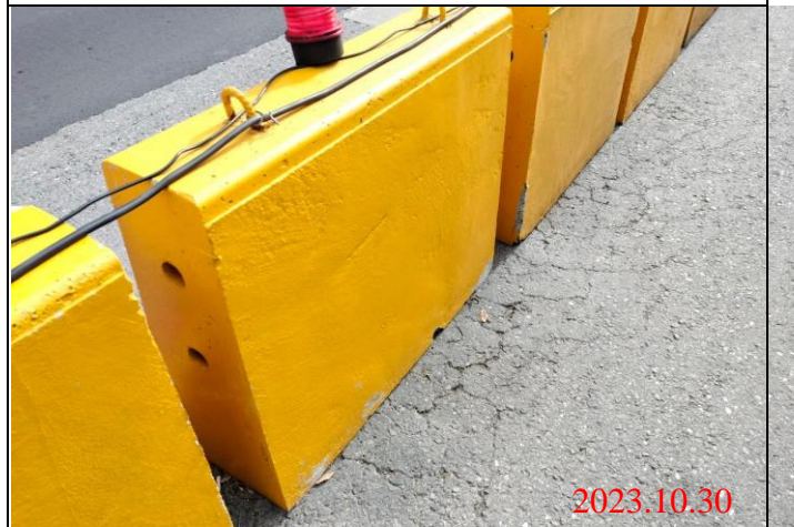
巡查日期地點：112.10.30/ Y23車站 照片說明：路面龜裂狀況
