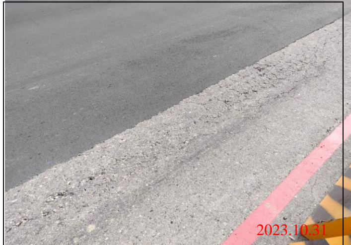
巡查日期地點：112.10.31/ Y23車站 照片說明：路面龜裂狀況
