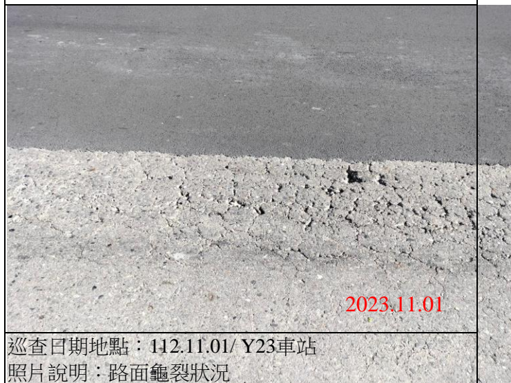
巡查日期地點：112.11.01/ Y23車站 照片說明：路面龜裂狀況
