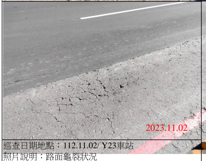
巡查日期地點：112.11.02/ Y23車站 照片說明：路面龜裂狀況
