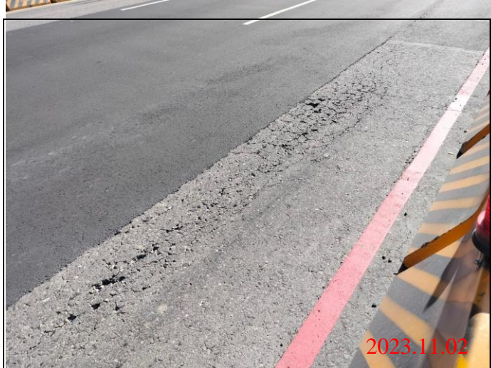
巡查日期地點：112.11.02/ Y23車站 照片說明：路面龜裂狀況
