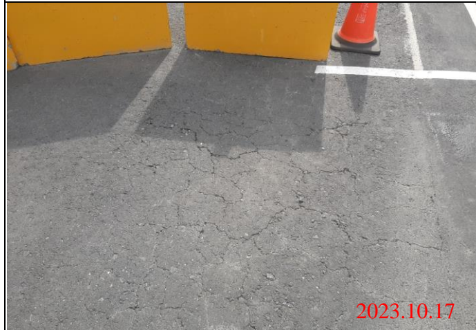
巡查日期地點：112.10.17/ Y23車站 照片說明：路面龜裂狀況
