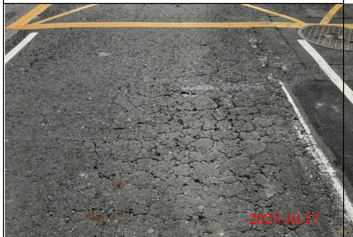
巡查日期地點：112.10.17/ Y23車站 照片說明：路面龜裂狀況
