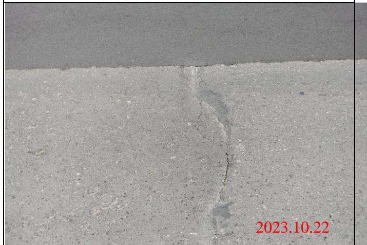
巡查日期地點：112.10.22/ Y23車站 照片說明：路面龜裂狀況
