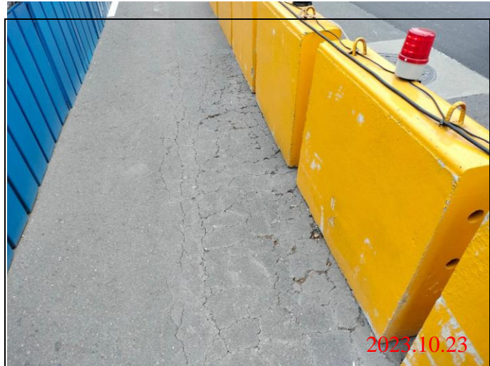
巡查日期地點：112.10.23/ Y23車站 照片說明：路面龜裂狀況
