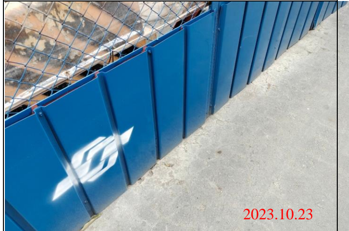
巡查日期地點：112.10.23/ Y23車站 照片說明：路面龜裂狀況
