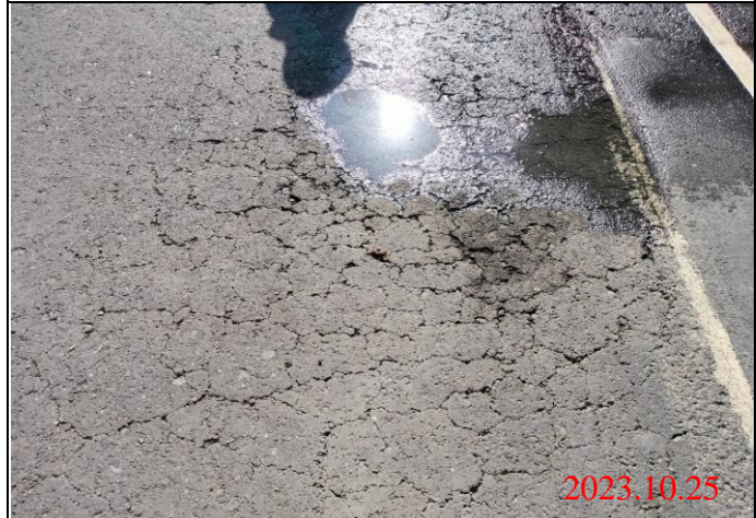
巡查日期地點：112.10.25/ Y23車站 照片說明：路面龜裂狀況
