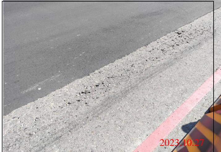
巡查日期地點：112.10.27/ Y23車站 照片說明：路面龜裂狀況
