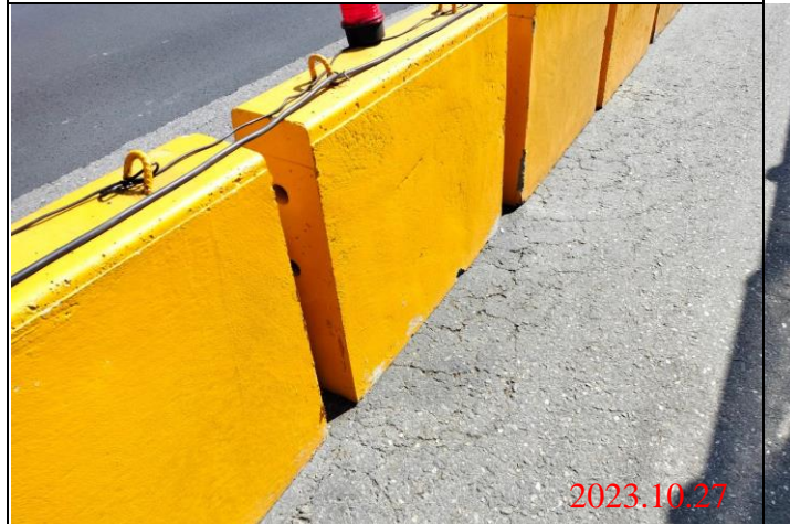
巡查日期地點：112.10.27/ Y23車站 照片說明：路面龜裂狀況
