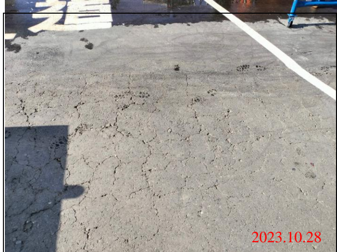
巡查日期地點：112.10.28/Y23車站 照片說明：路面龜裂狀況
