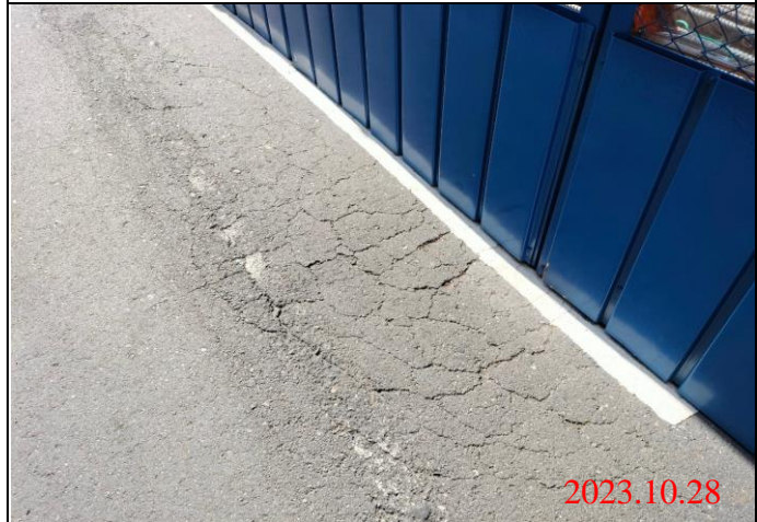
巡查日期地點：112.10.28/ Y23車站 照片說明：路面龜裂狀況
