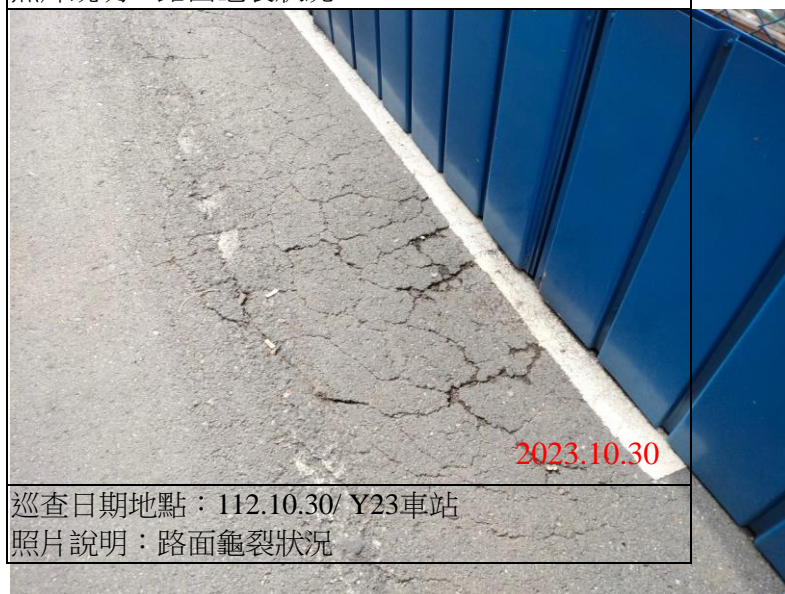
巡查日期地點：112.10.30/ Y23車站 照片說明：路面龜裂狀況
