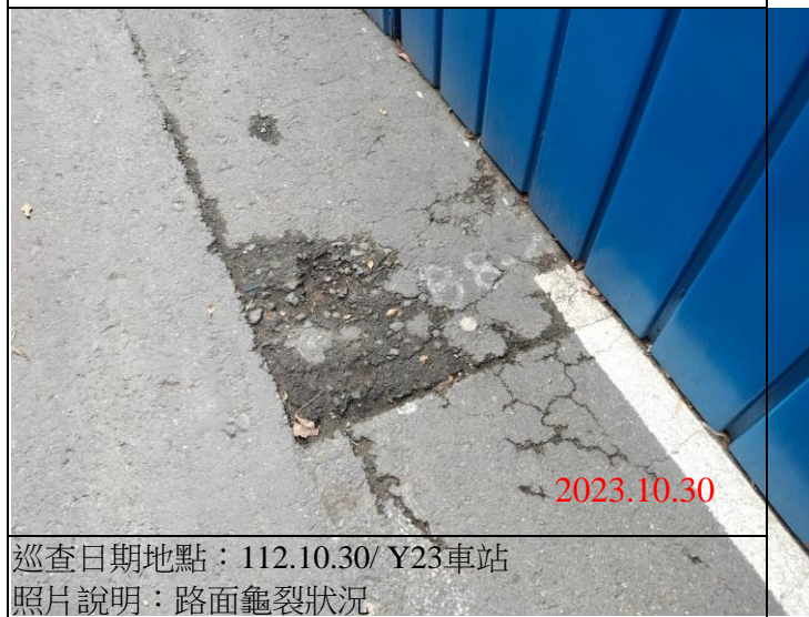
巡查日期地點：112.10.30/ Y23車站 照片說明：路面龜裂狀況
