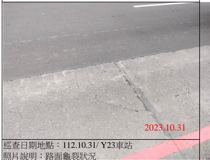
巡查日期地點：112.10.31/ Y23車站 照片說明：路面龜裂狀況
