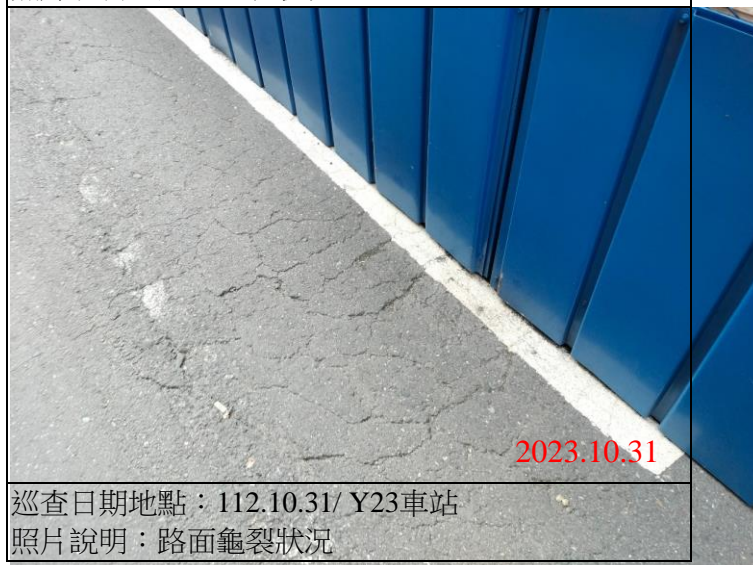
巡查日期地點：112.10.31/ Y23車站 照片說明：路面龜裂狀況
