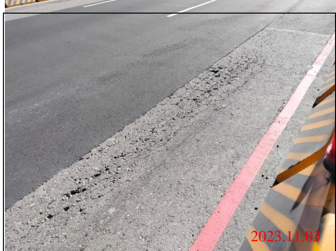
巡查日期地點：112.11.03/ Y23車站 照片說明：路面龜裂狀況
