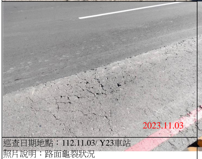
巡查日期地點：112.11.03/ Y23車站 照片說明：路面龜裂狀況
