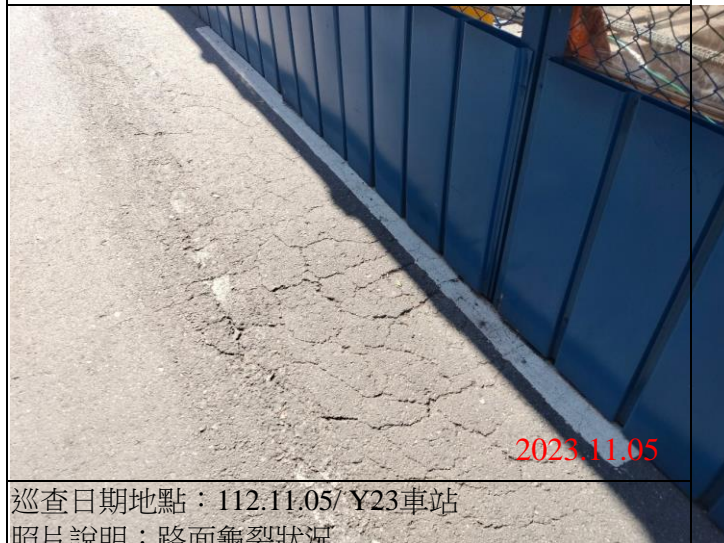
巡查日期地點：112.11.05/ Y23車站 照片說明：路面龜裂狀況
