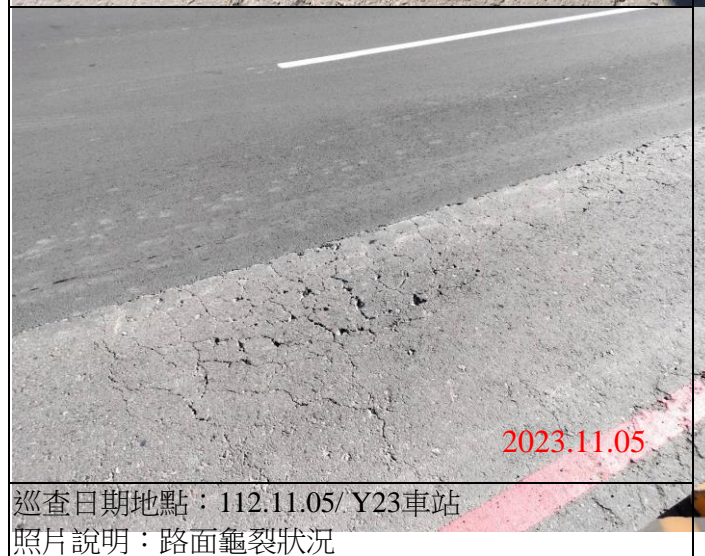
巡查日期地點：112.11.05/ Y23車站 照片說明：路面龜裂狀況
