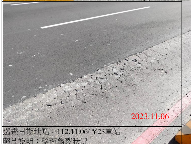
巡查日期地點：112.11.06/ Y23車站 照片說明：路面龜裂狀況
