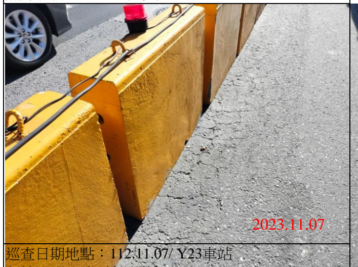
巡查日期地點：112.11.07/ Y23車站 照片說明：路面龜裂狀況
