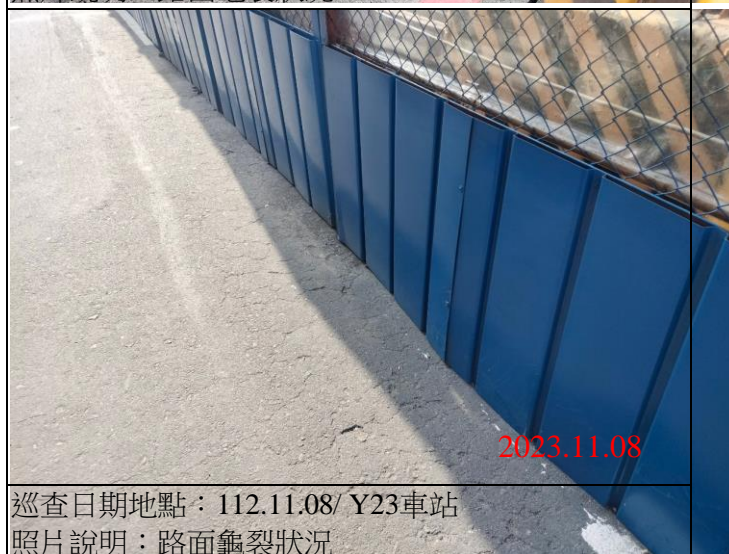
巡查日期地點：112.11.08/ Y23車站 照片說明：路面龜裂狀況
