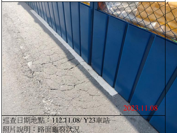
巡查日期地點：112.11.08/ Y23車站 照片說明：路面龜裂狀況
