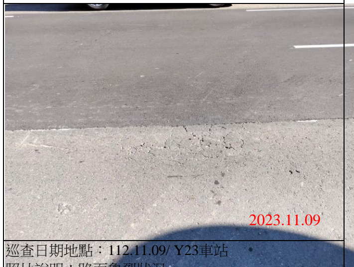
巡查日期地點：112.11.09/ Y23車站 照片說明：路面龜裂狀況
