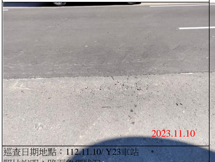
巡查日期地點：112.11.10/Y23車站 照片說明：路面龜裂狀況
