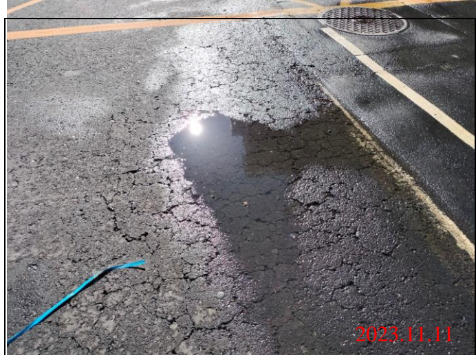
巡查日期地點：112.11.11/Y23車站 照片說明：路面龜裂狀況
