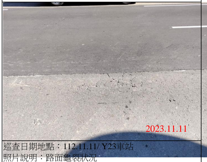
巡查日期地點：112.11.11/Y23車站 照片說明：路面龜裂狀況
