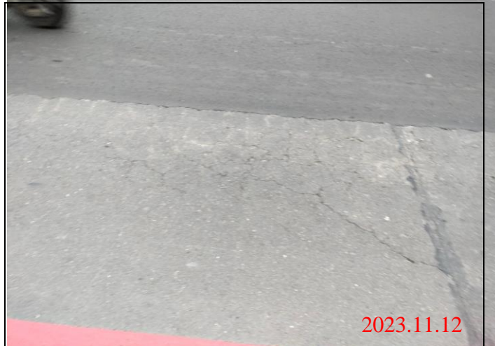
巡查日期地點：112.11.12/ Y23車站 照片說明：路面龜裂狀況
