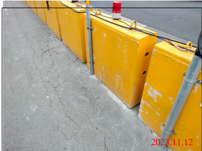
巡查日期地點：112.11.12/ Y23車站 照片說明：路面龜裂狀況
