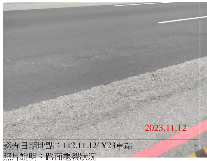
巡查日期地點：112.11.12/ Y23車站 照片說明：路面龜裂狀況
