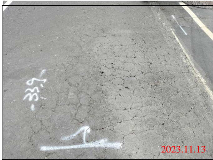
巡查日期地點：112.11.13/ Y23車站 照片說明：路面龜裂狀況
