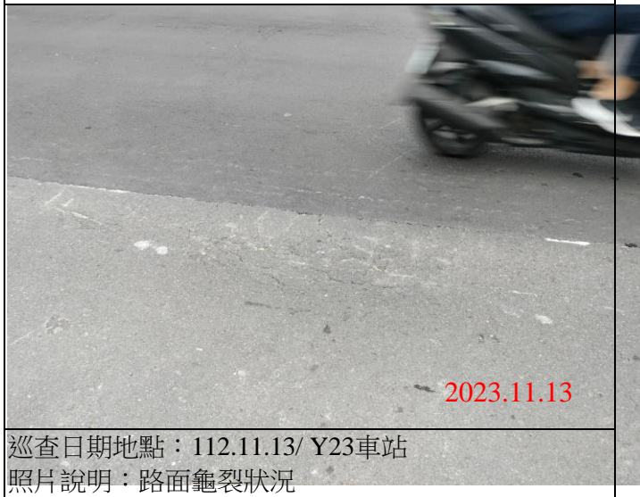
巡查日期地點：112.11.13/ Y23車站 照片說明：路面龜裂狀況
