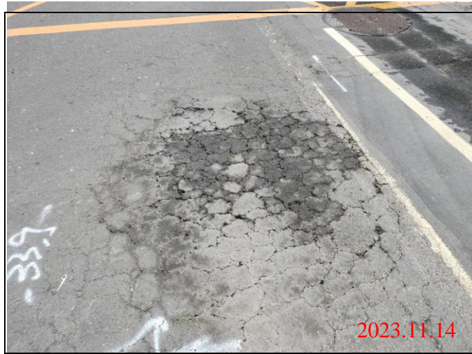
巡查日期地點：112.11.14/ Y23車站 照片說明：路面龜裂狀況
