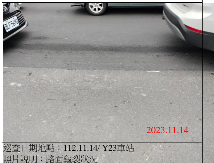
巡查日期地點：112.11.14/ Y23車站 照片說明：路面龜裂狀況
