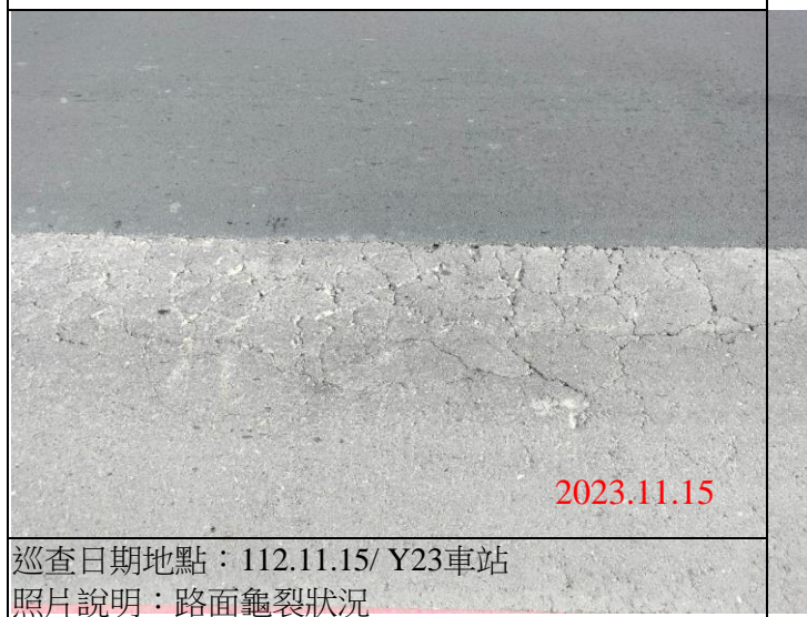
巡查日期地點：112.11.15/ Y23車站 照片說明：路面龜裂狀況
