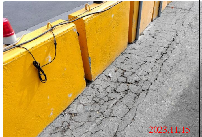
巡查日期地點：112.11.15/ Y23車站 照片說明：路面龜裂狀況
