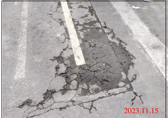
巡查日期地點：112.11.15/ Y23車站 照片說明：路面龜裂狀況
