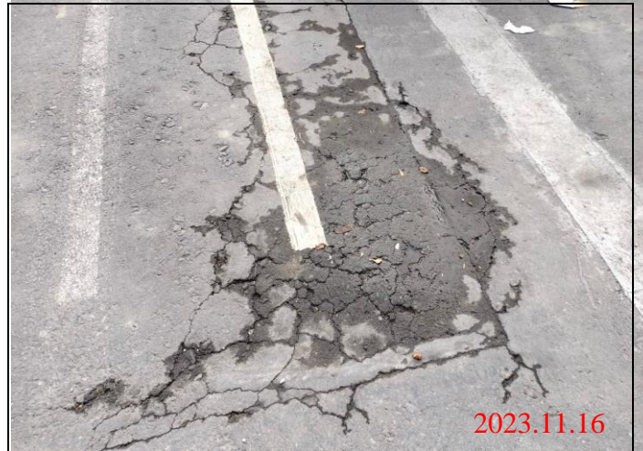
巡查日期地點：112.11.16/ Y23車站 照片說明：路面龜裂狀況
