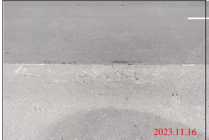
巡查日期地點：112.11.16/ Y23車站 照片說明：路面龜裂狀況
