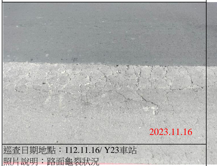
巡查日期地點：112.11.16/ Y23車站 照片說明：路面龜裂狀況
