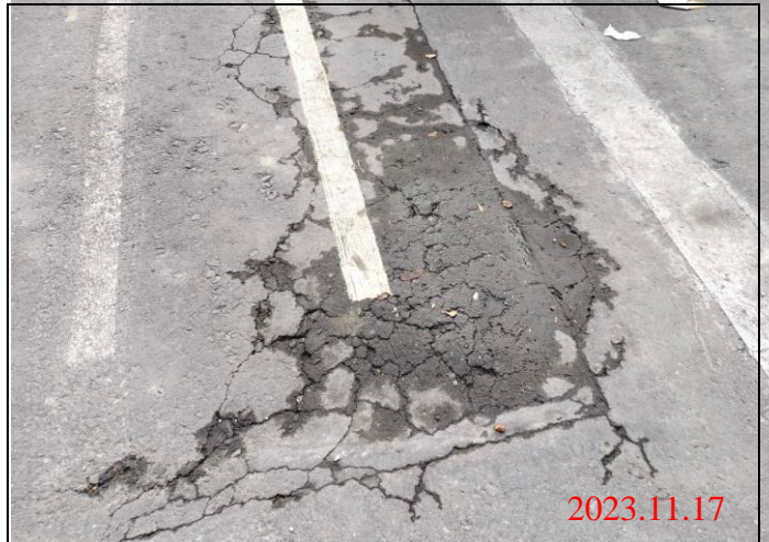
巡查日期地點：112.11.17/ Y23車站 照片說明：路面龜裂狀況
