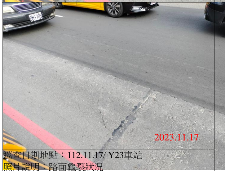
巡查日期地點：112.11.17/ Y23車站 照片說明：路面龜裂狀況
