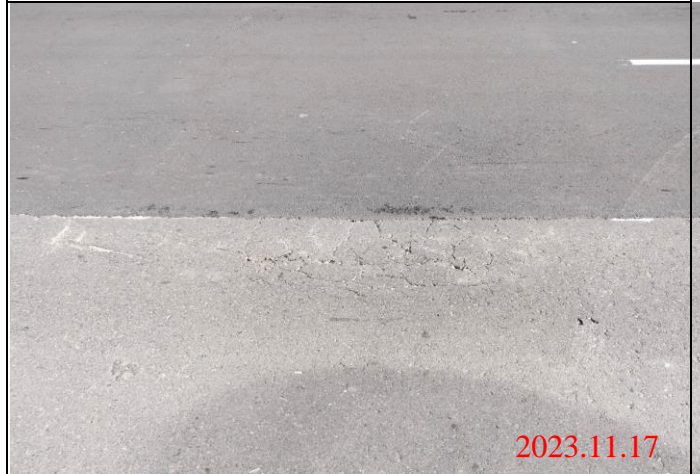
巡查日期地點：112.11.17/ Y23車站 照片說明：路面龜裂狀況
