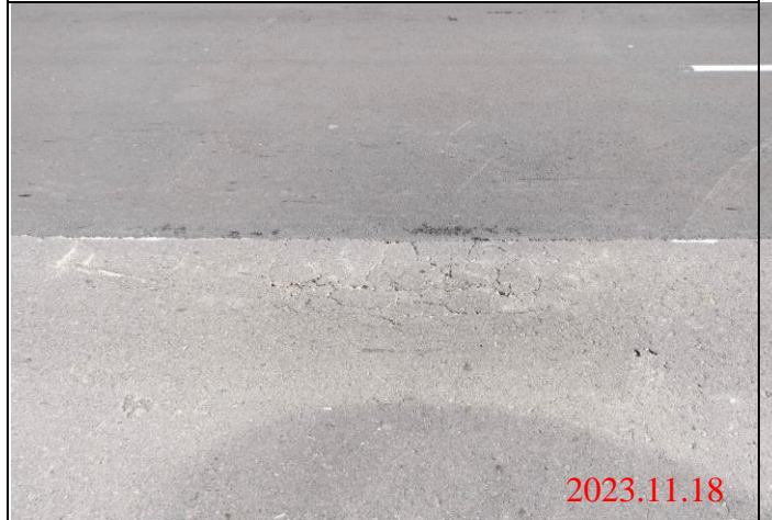
巡查日期地點：112.11.18/ Y23車站 照片說明：路面龜裂狀況
