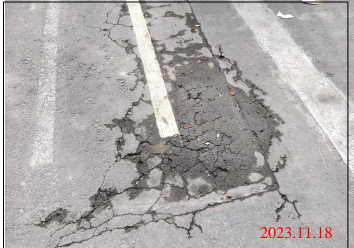
巡查日期地點：112.11.18/ Y23車站 照片說明：路面龜裂狀況
