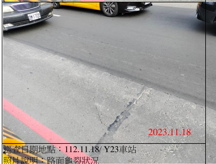
巡查日期地點：112.11.18/ Y23車站 照片說明：路面龜裂狀況
